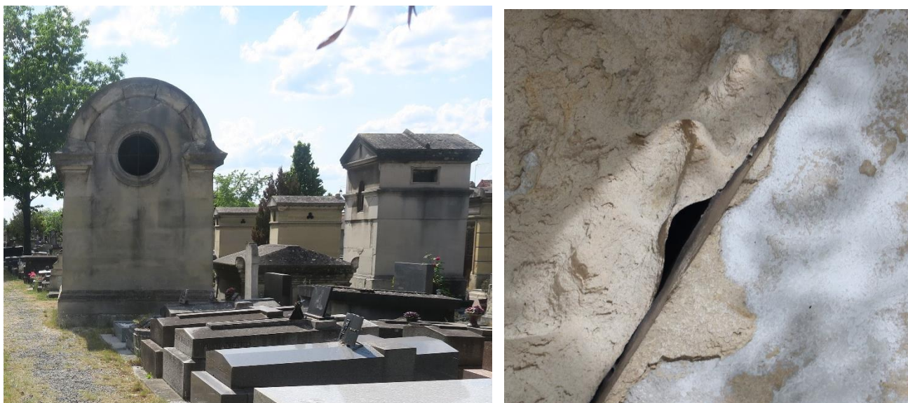
Figure 30: Laisser des ouvertures dans les chapelles, ne pas rejoiner les fissures (Ecolo GIE 2022)
